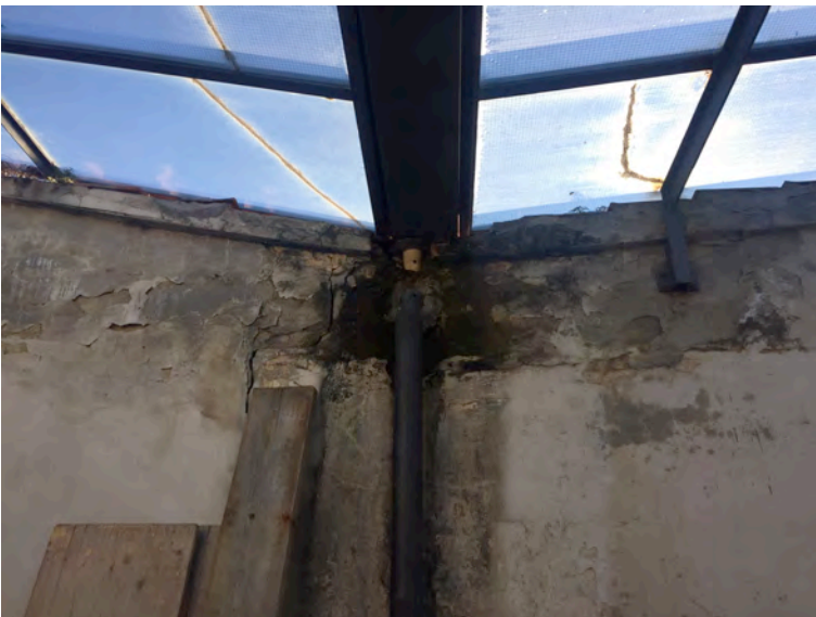
Vetri da sostituire
