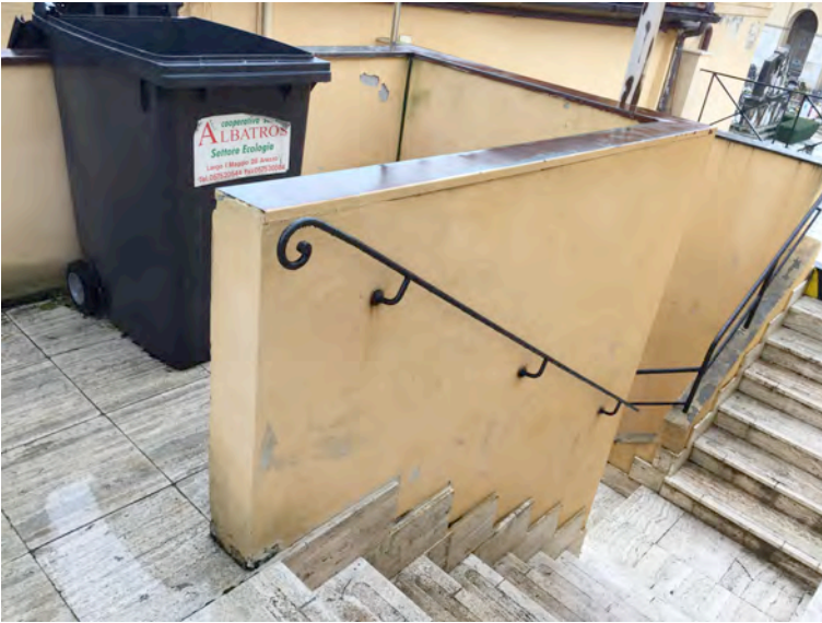
Cimasa da sostituire
